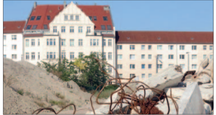
Blick vom Eutritzscher Freiladebahnhof zur Eutritzscher Straße 41–45, am 11. September 2020. Berge von Abbruchmaterial türmen sich auf dem Areal.
